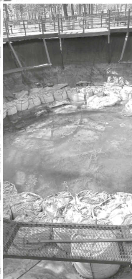
► Пруд до очистки
