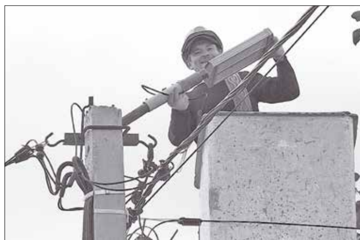
Уличное электрохозяйство посёлка – на обслуживании ООО «Голышмановоэнергосервис»
