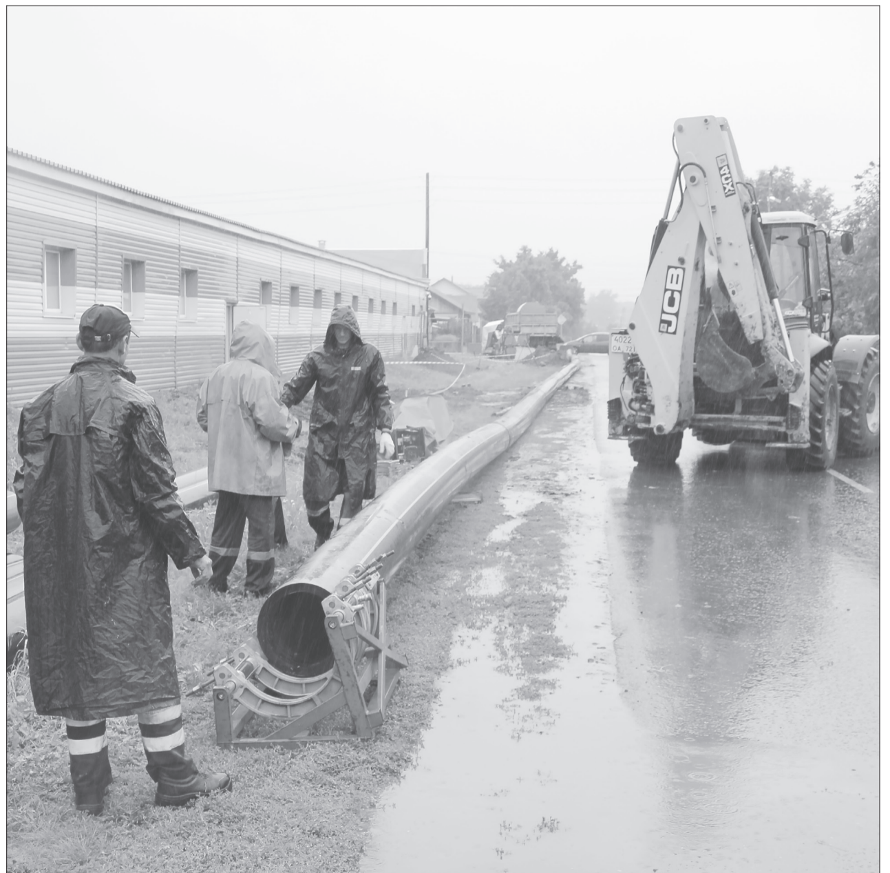
Бригада мастера водопроводного участка Дмитрия Киклевича укладывает трубы даже под дождём /ФОТО АВТОРА
