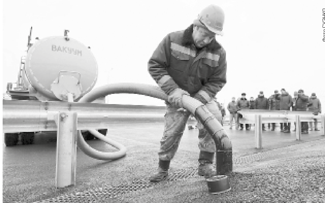
Пропускная способность сливной станции – 250 м³ в сутки
