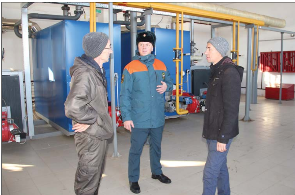
• Главный инженер ООО «Коммунальное хозяйство» Евгений Сотников (справа) и оператор котельных Сергей Упоров рассказывают о состоянии объекта теплоснабжения начальнику отделения надзорной деятельности и профилактической работы по Аромашевскому району Сергею Курденко (в центре).
