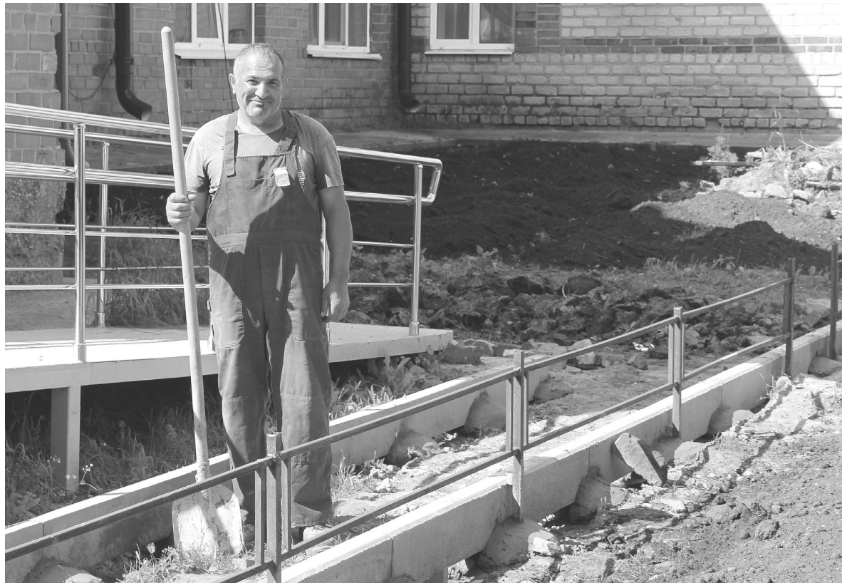
Работник ООО «Перлит» Андриак Абаджян готовит песочную подушку под щебень и асфальт для тротуарных дорожек
