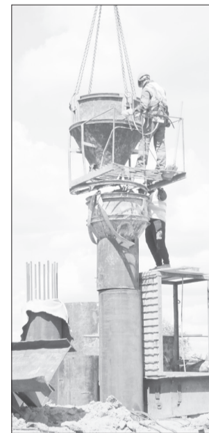
Все меняют полностью, а сначала монтируют сваи пролёта, как здесь, на реке Чакче
