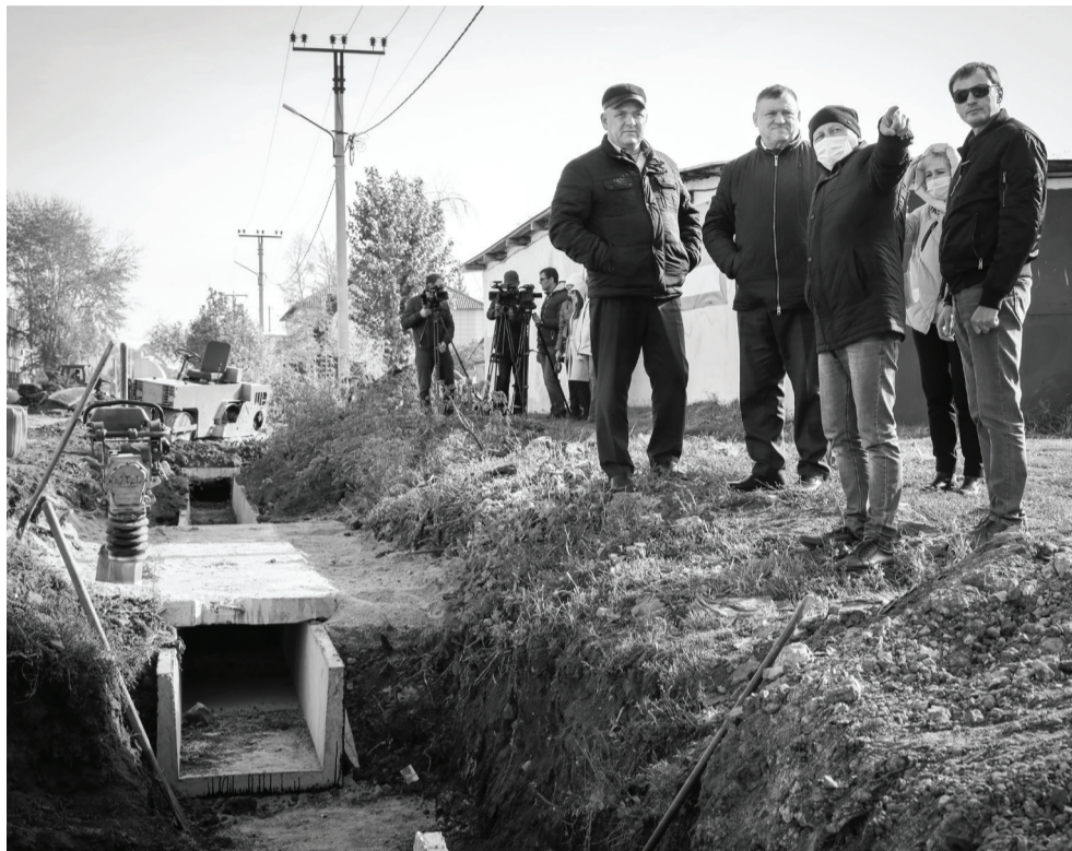
Из-за высокого уровня грунтовых вод в периоды снеготаяния или сильных дождей низкие участки в границах улиц К.Маркса – Б.Садовая – Артиллерийская – Комсомольская часто затопляло. Новая система поможет решить давнюю проблему с подтоплениями. // Фото Василия БАРАНОВА.
