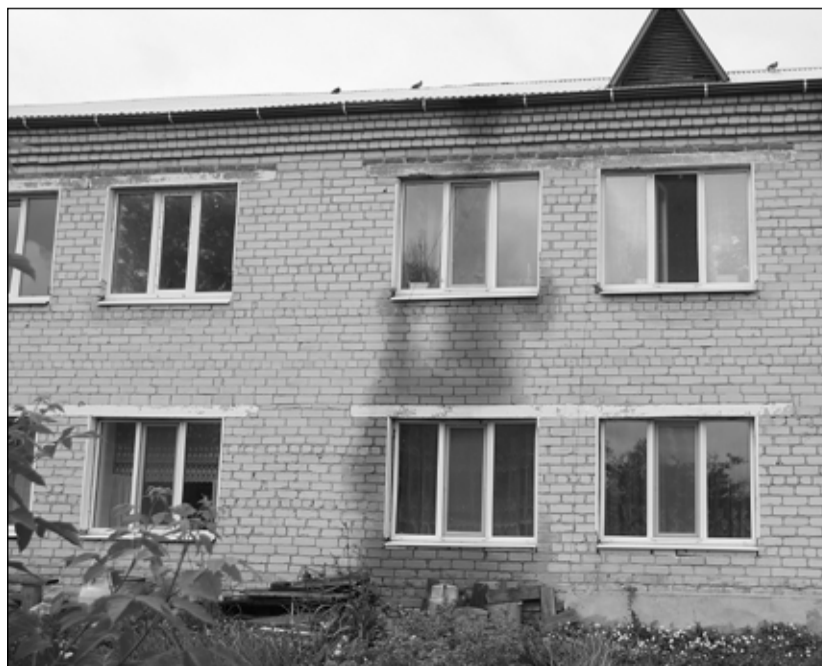
Мокнет стена дома из-за нарушенного водостока
