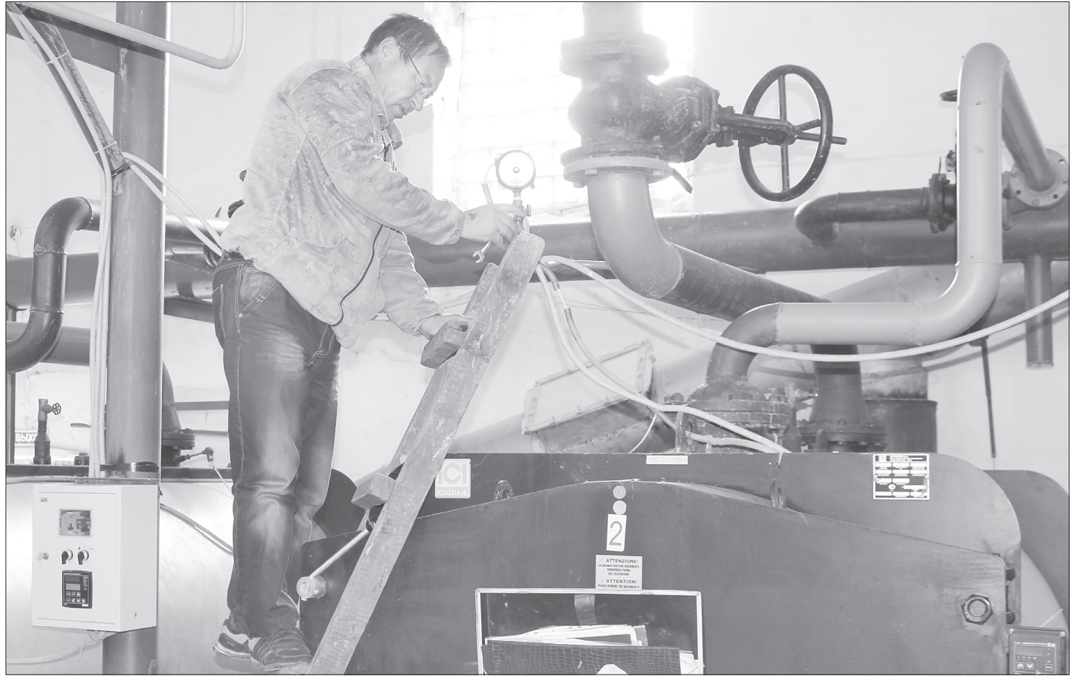
В беркутской котельной идут последние приготовления к запуску. Буквально на днях смонтированы приборы учёта, вернувшиеся с поверки /ФОТО АВТОРА
