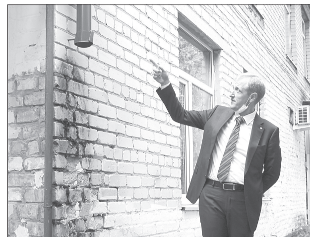
Осмотрев проблемные места здания, которые видно невооружённым глазом, Алексей Райдер согласился, что вопрос о капитальном ремонте или строительстве нового детсада необходимо решать /ФОТО АЛЕКСАНДРА СМЕРНОВА
