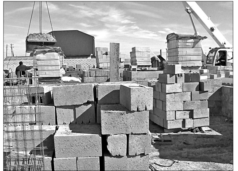
Активно идёт стройка многоквартирника в посёлке – на пересечении улиц Комсомольской и 8 Марта, первый этаж из трёх почти готов
