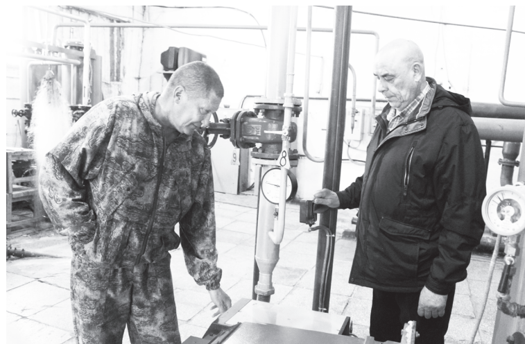
Газовые котельные обеспечивают теплом общественные здания и жилые дома
