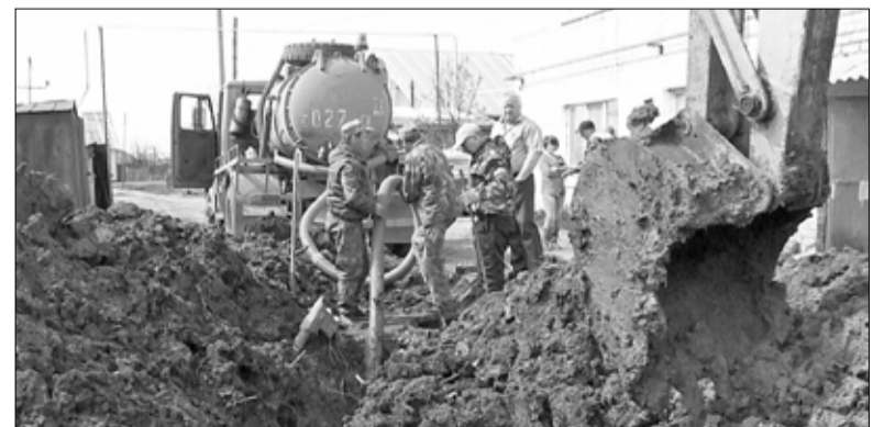
Работники коммунальной службы ведут установку новой канализационной ёмкости во дворе дома № 154 по улице Карла Маркса
