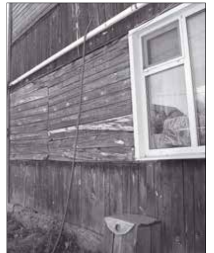
В доме № 3 по улице Пушкина шланги выводят даже со второго этажа
