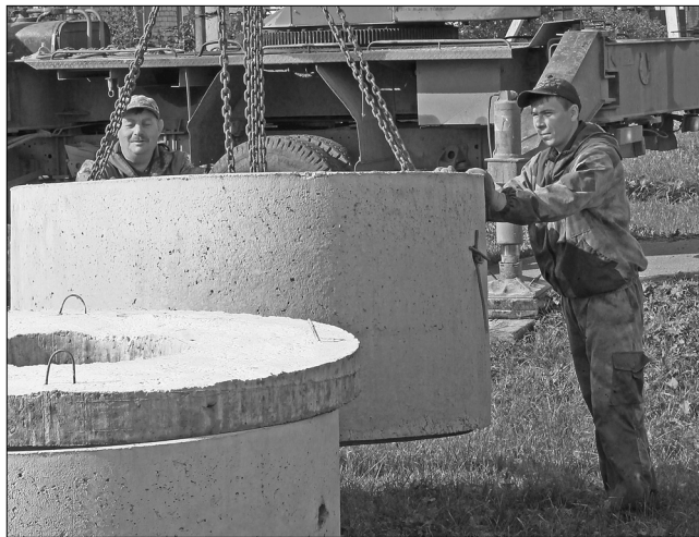
Юрий Елишев и Виктор Саидов принимают бетонные кольца для строительства водопроводных колодцев
