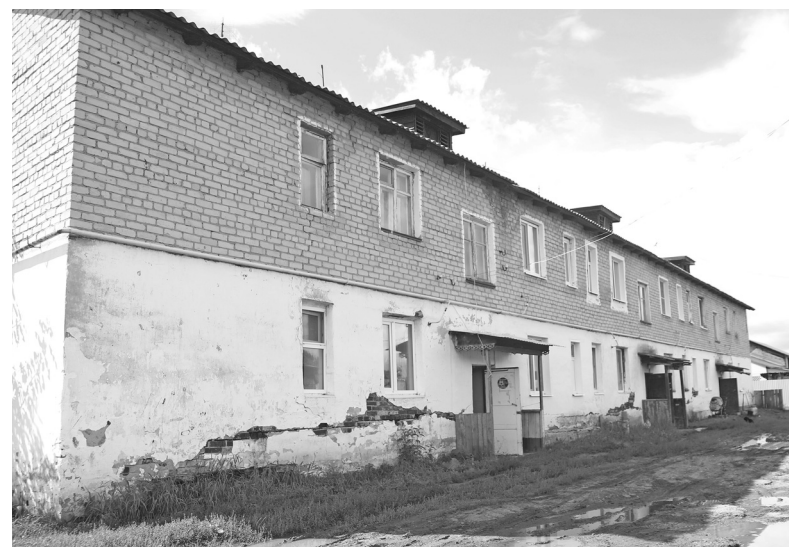
Обветшалый фасад двухэтажки в селе Малышенка давно требует ремонта
