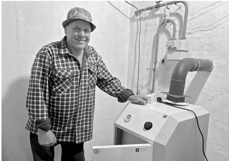
Сергей Тубалев: «Котельная, отапливающая Дом культуры и администрацию в Земляной, тоже небольшая по площади»
