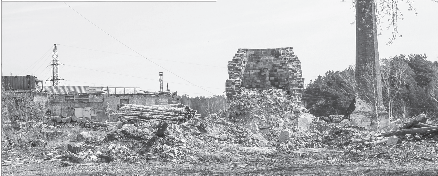
Оригинальная по конструкции заводская труба «сдалась» последней – рухнула она весной прошлого года /ФОТО АЛЕКСАНДРА СМЕРНОВА
