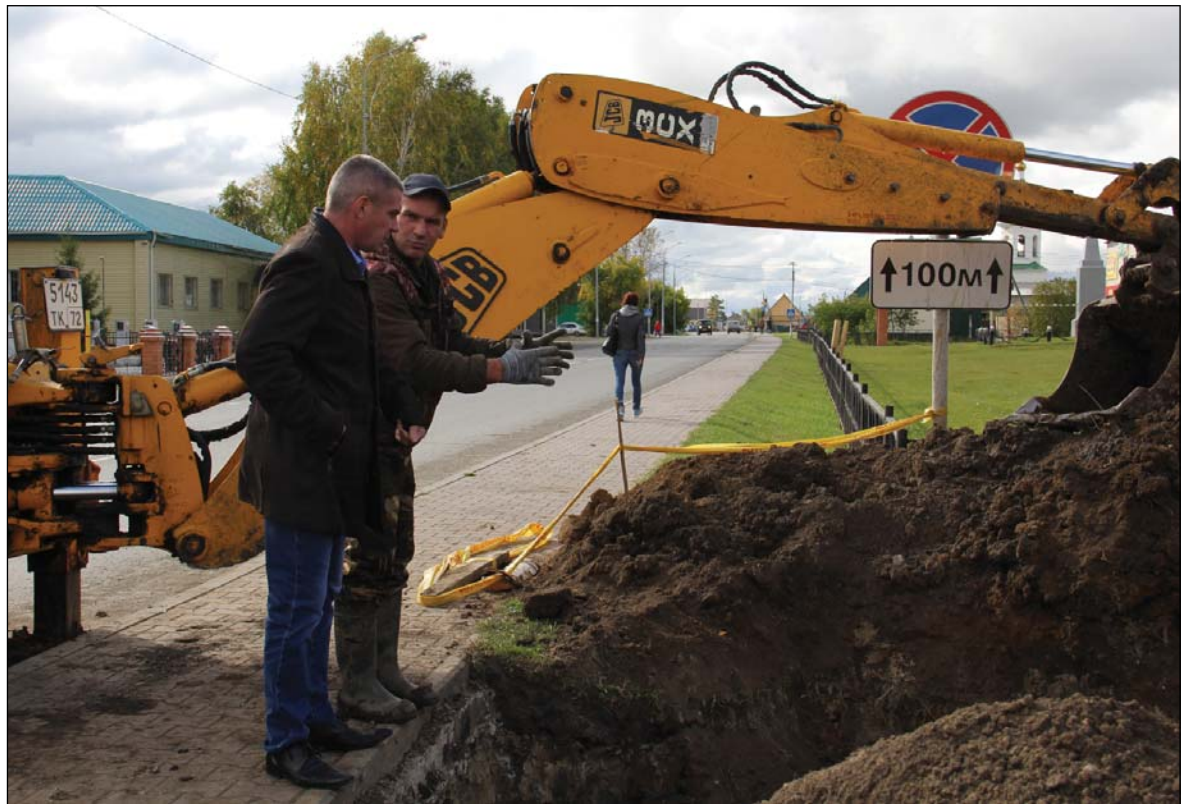
• Руководитель муниципалитета Игорь Власов проверил, на каком этапе идёт ремонт тепловых сетей.
