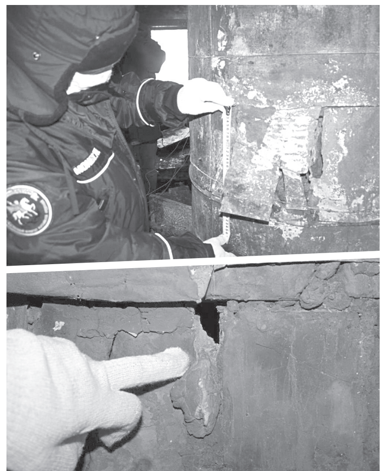
По словам криминалистов, пожар мог начаться из-за отверстия в печи, которое было обнаружено в ходе осмотра места происшествия /ФОТО СУ СК РФ ПО ТЮМЕНСКОЙ ОБЛАСТИ
