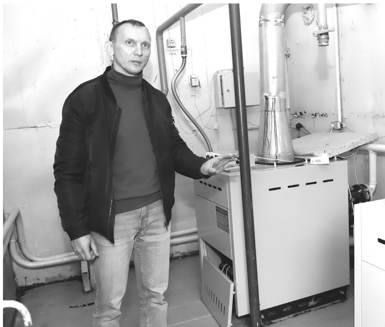
Директор ООО «Голышмановотеплосервис» Иван Грачёв рассказывает о работе котельной детского сада № 2 «Зёрнышко» в посёлке Голышманово
