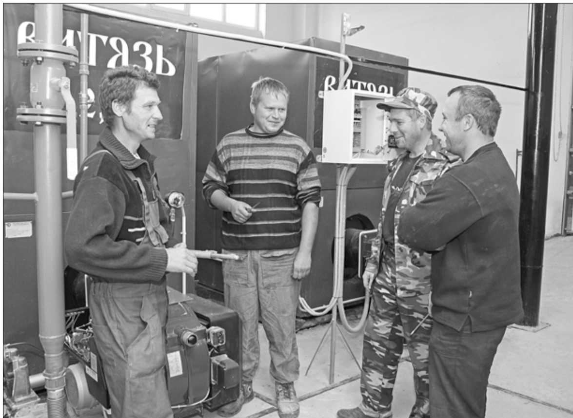
Специалисты компании «Никос» завершают наладку оборудования в центральной котельной
