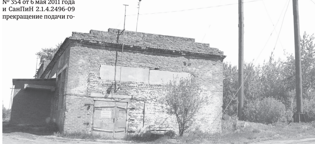
Сроки отключения горячей воды в домах, запитанных от котельной № 11, пришлось увеличить, так как тепловому пункту требуется капитальный ремонт /ФОТО АЛЕКСАНДРА СМЕРНОВА
