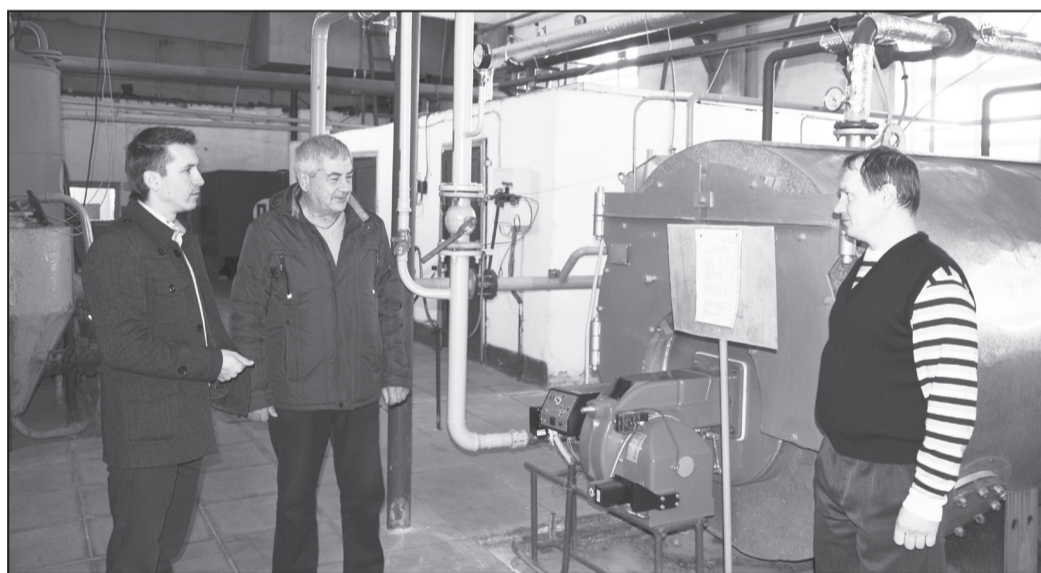
Котельная работает в штатном режиме.
