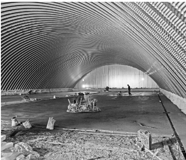
* Завод по производству теляпии
