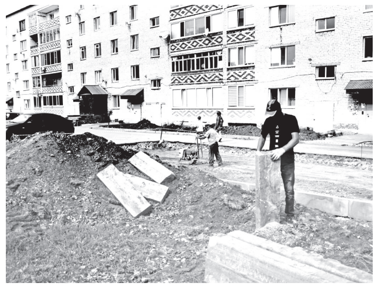
• Работы во дворе между домами № 13, № 19 и № 21 на улице Заводской в Заводоуковске идут полным ходом. Уже осенью эту неприглядную территорию будет не узнать.
