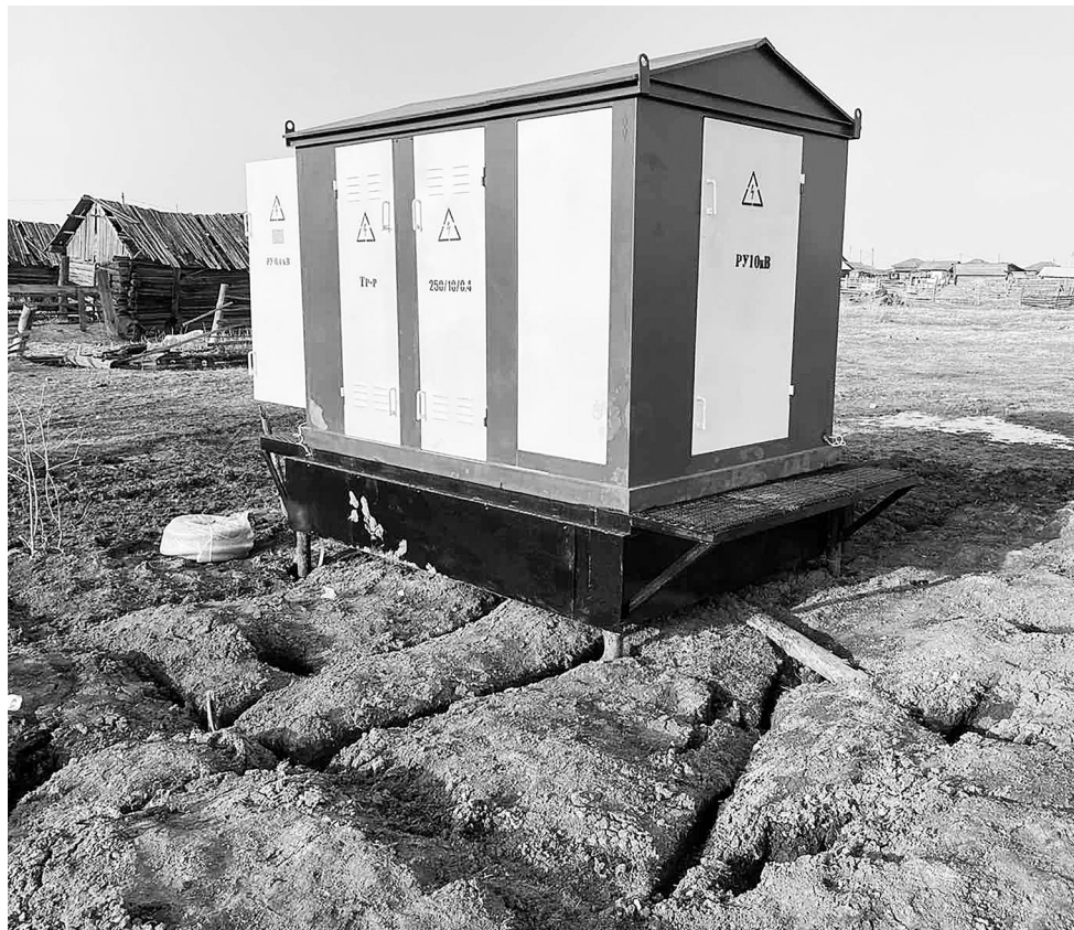
Новый объект появился в селе Кускургуль – трансформаторная подстанция 10/0,4 кв.
