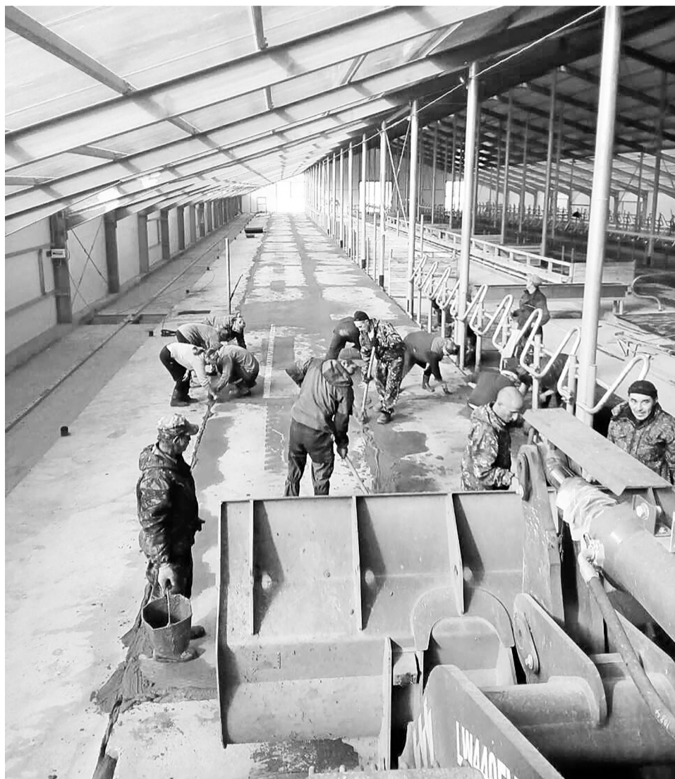
Горячий цемент не ждёт – в работе весь коллектив. Снимок сделан из кабины трактора, за рулём которого – руководитель хозяйства Соломон Шармазанов. Это фото – наглядный пример того, как возводилась эта ферма.
