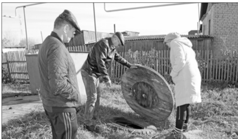
Жильцам дома № 154 по улице Карла Маркса приходится ежедневно проверять канализационный колодец
