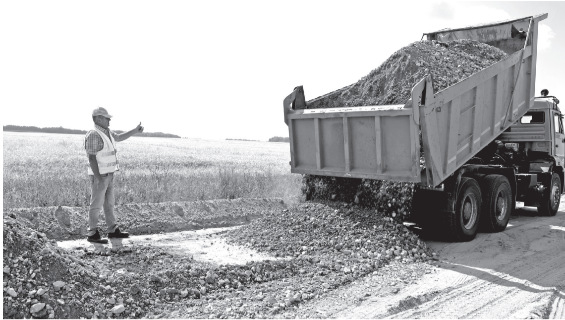
• Ремонт участка автодороги Заводоуковск–Новолыбаево–Ингалинское от села Шиликуль до границы Упоровского района в самом разгаре.
