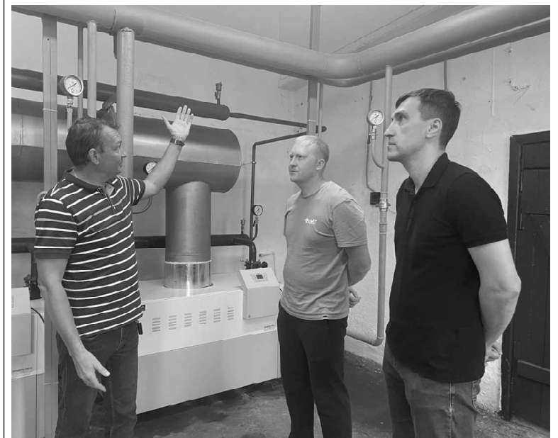
Технический директор ООО «Ромист» Евгений Яковлев рассказывает о тепловой мощности котельной членам Общественной палаты Артемию Смирнову и Евгению Пермякову
