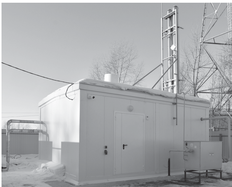
Одна из двух газовых котельных, введённых в строй на территории поселения в 2022 году
