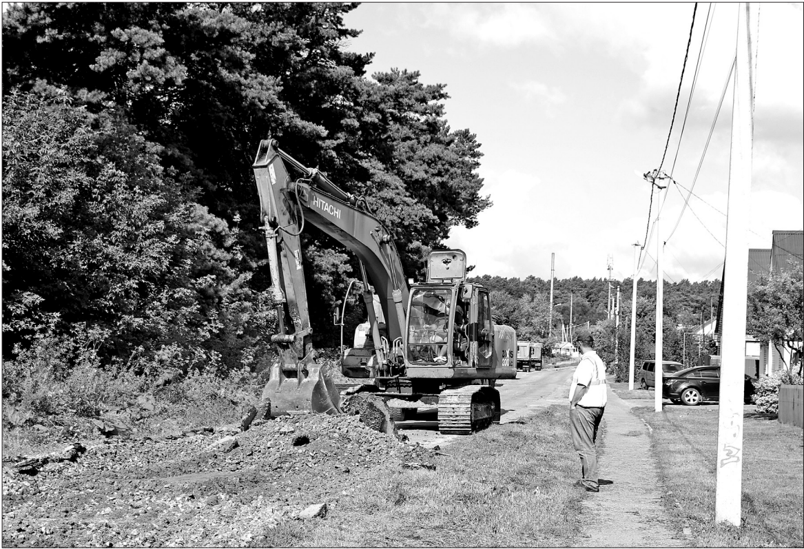
Старое дорожное покрытие на участке улицы Полугорной (от Декабристов до Щорса) в городе оставляло желать лучшего, но скоро здесь будет новый ровный асфальт. /ФОТО АВТОРА
