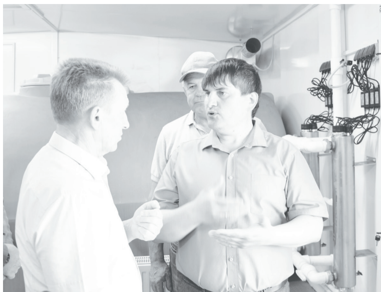
О современной системе очистки воды главе района Леониду Саукову рассказывает директор МУП «РКХ-2» Андрей Бондаренко.
