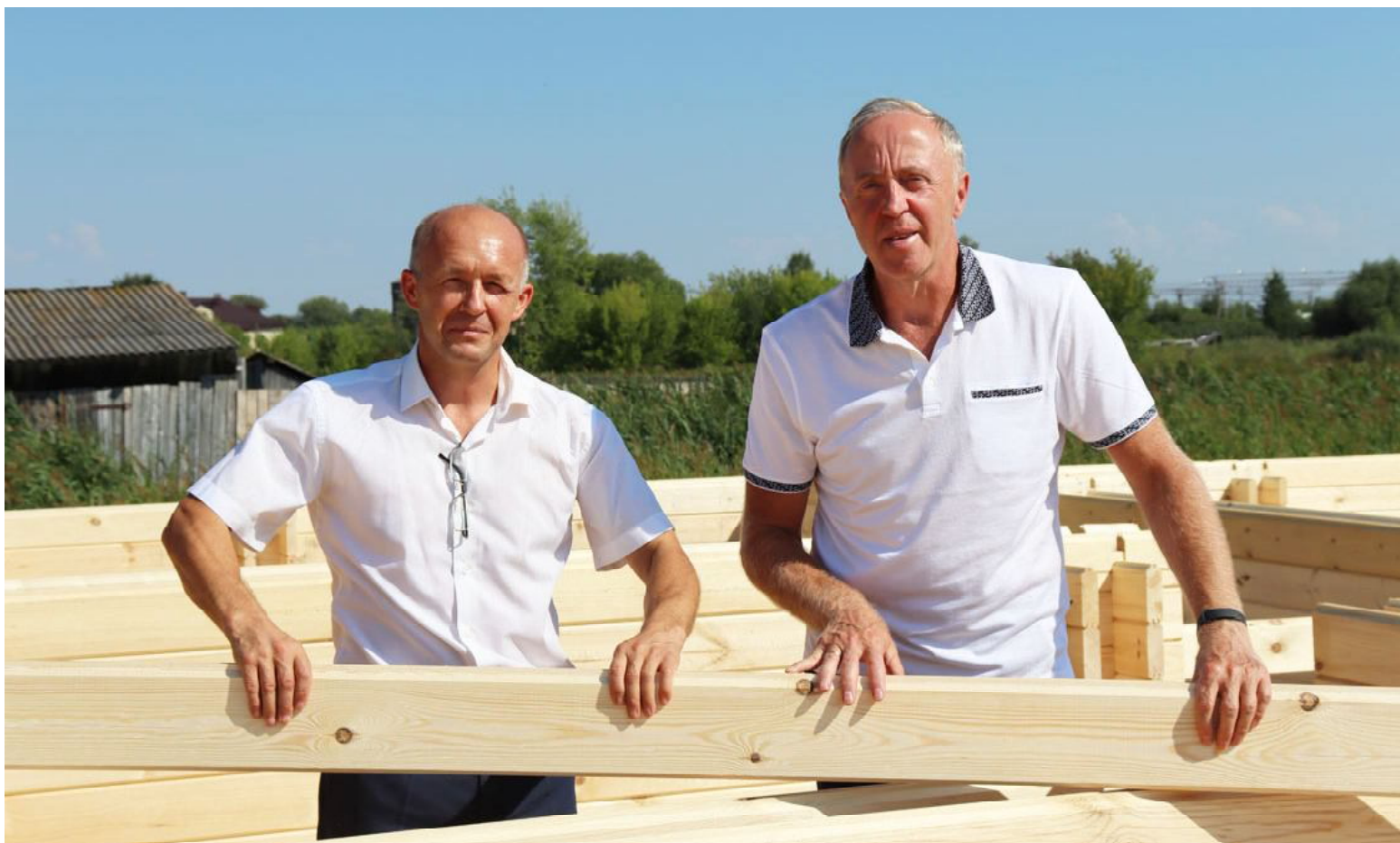
Депутат областной Думы Виктор Рейн и глава Вагайского сельского поселения Сергей Новиков осматривают строительство дома для многодетной семьи
