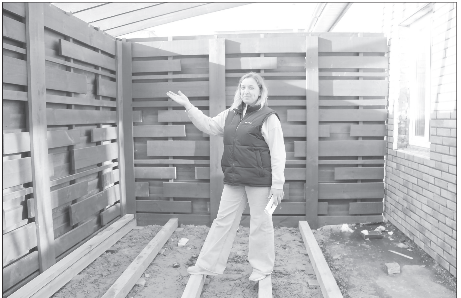
Директор ООО «Банно-прачечный комбинат» Ольга Тимофеева показывает основу площадки для отдыха, которая появится после реконструкции бани
