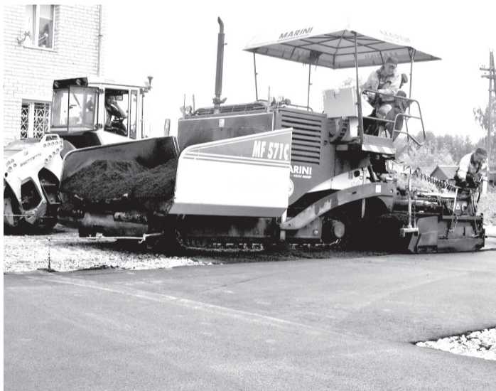
• При строительстве автостоянок во дворе домов 9а и 7а на городской улице Заводской дорожники предусмотрели и водоотведение.
