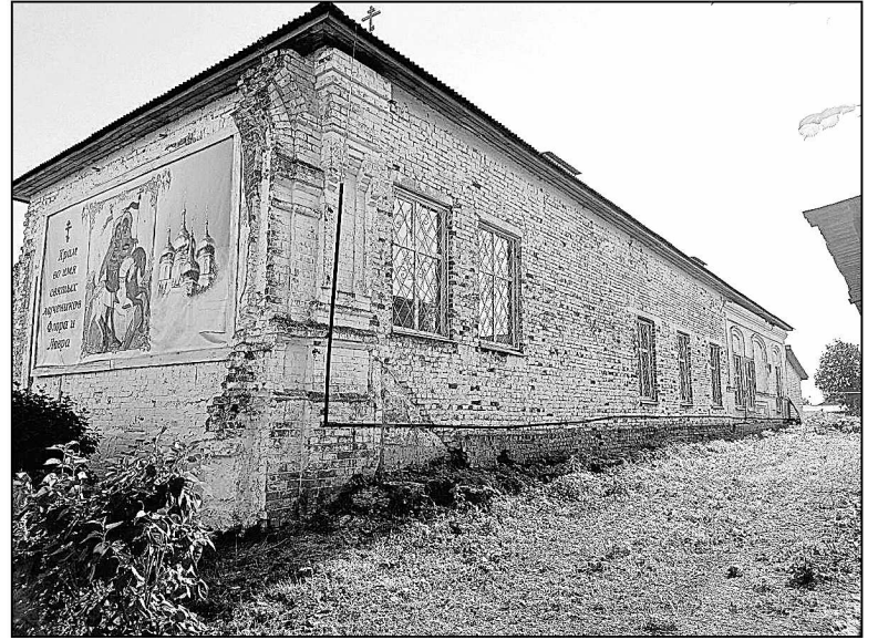
Здание храма требует реконструкции.
