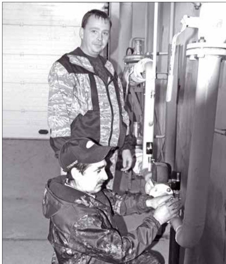
Мастер Александр Чернокутов и диспетчер Евгений Землянов на запуске центральной котельной
