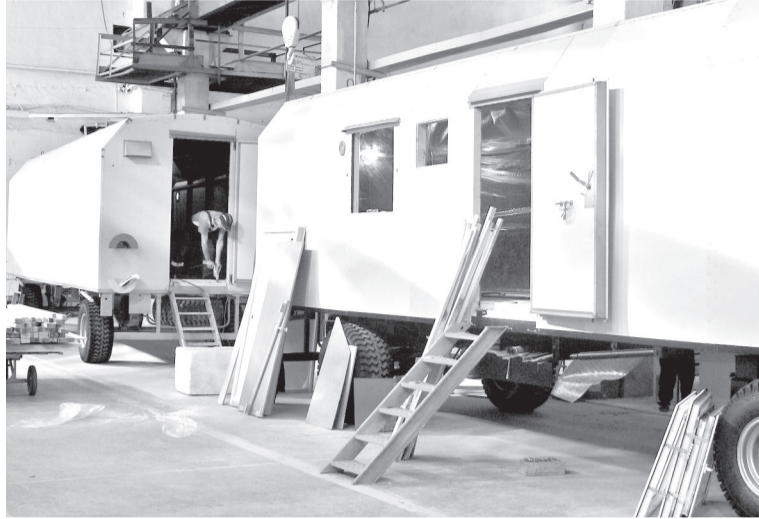
• В одном вагоне заводчане вставляют окна и навешивают двери, в другом – укладывают теплоизоляцию, в следующем – устанавливают мебель, красят...
