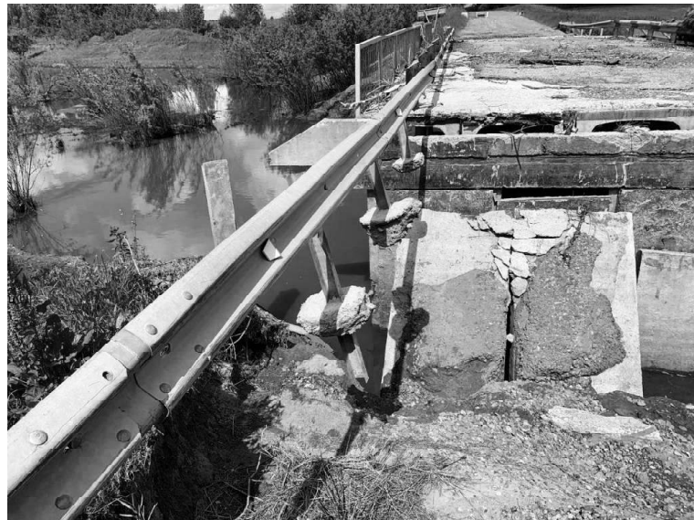
➤ Мост через р. Сартамок близ с. Долгушино после паводка и сейчас // Фото с сайта администрации района
