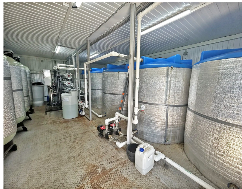
Так выглядит станция водоподготовки изнутри
