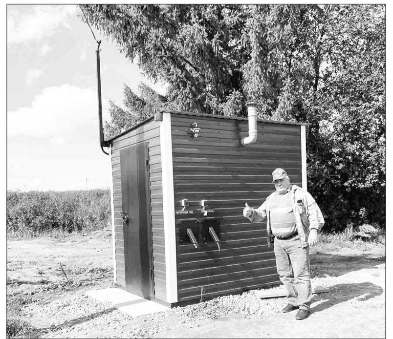
Станция водоочистки в д. Бития
