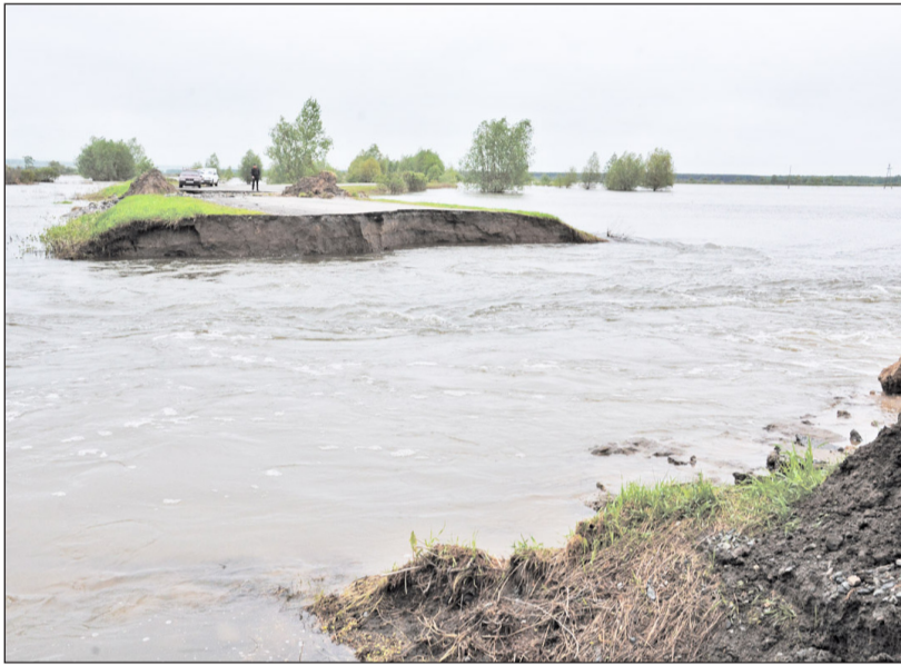
Паводок 2017 года. Этот участок дороги Казанское – Пешнёво пришлось восстанавливать
