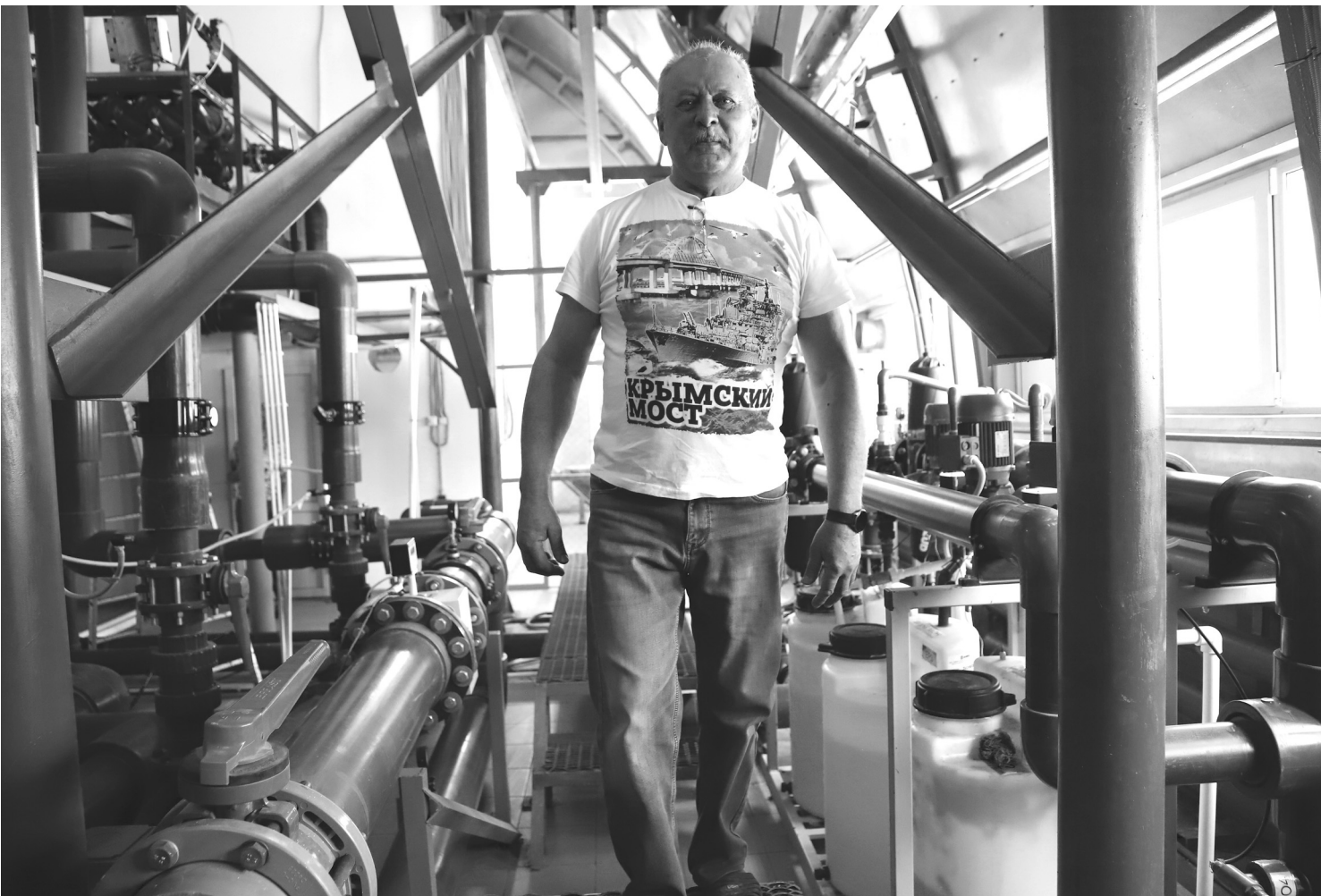
Оператор станции водоочистки Александр Мальгавко совершает обход объекта каждые два часа
