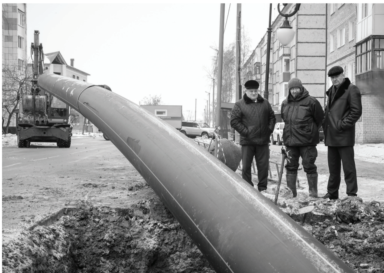
Запас мощности нового коллектора рассчитан до 20 тысяч кубометров, что позволит подключать новых абонентов. // Фото Василия БАРАНОВА.
