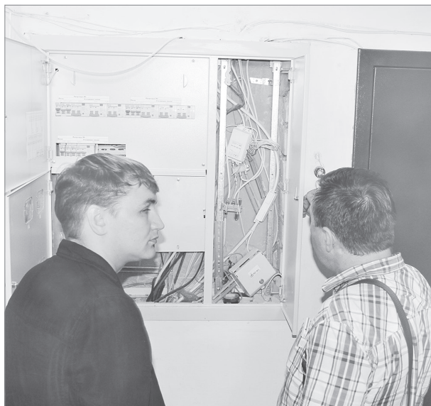
В электрощитовой на Новикова, 32 теперь полный порядок, установлено новое оборудование
