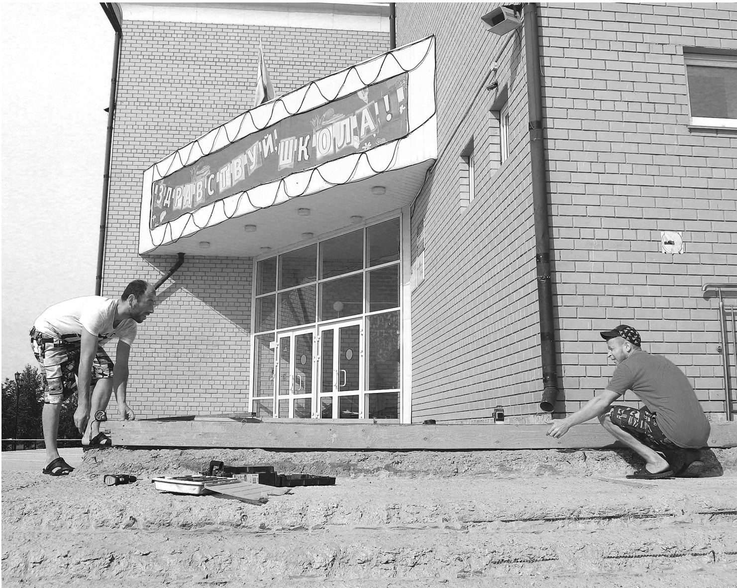
– Крыльцо – здания лицо, – уверены прораб Рудик Мкртчян и монтажник Валерий Степанов. Работы они ведут в МАОУ «Голышмановская СОШ № 2»
