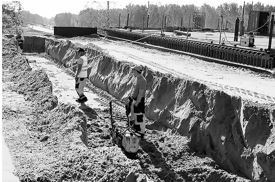
Тюменская кольцевая дорога – важнейший проект региона. Строительство одного из участков на ней руководил Виктор Поветкин.
