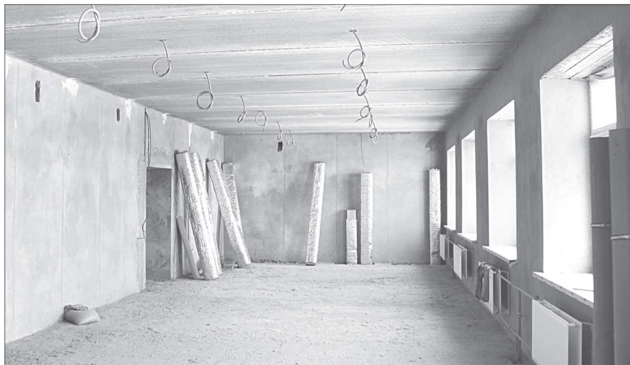
В ближайшие дни в помещениях поликлиники начнётся чистовая отделка и монтаж освещения /ФОТО АВТОРА
