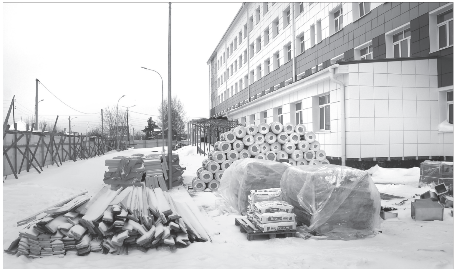
Строители уже выполнили почти все наружные работы, осталось смонтировать крышу входной группы и пандуса /ФОТО АВТОРА
